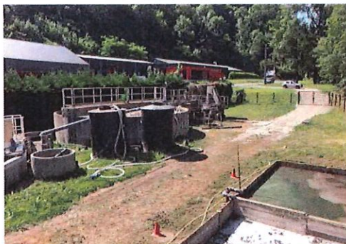
Tout un pôle économique est dépendant de la station d'épuration. Roger Lassebie
